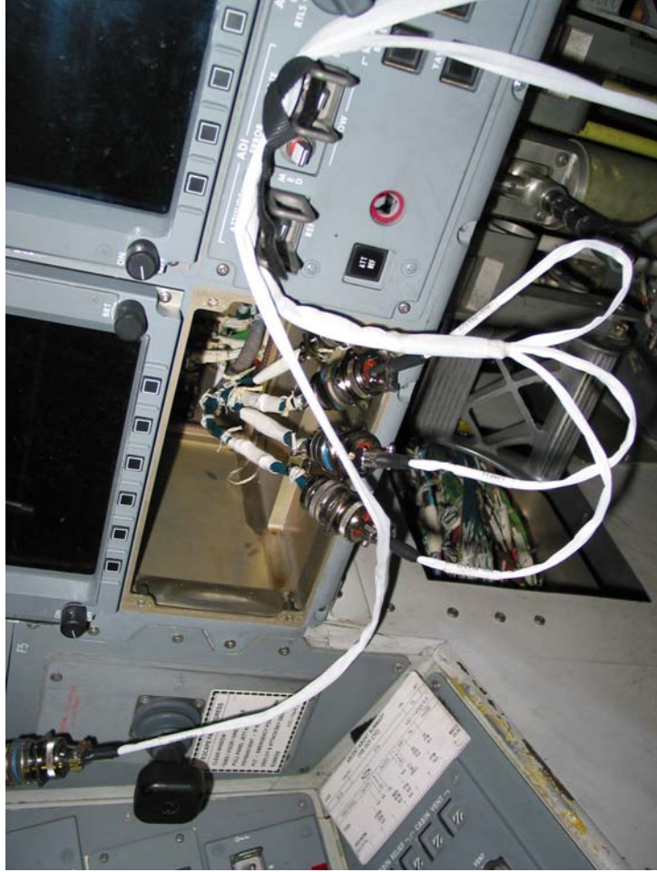
PNL F6A3 (Landing Gear Controls)
