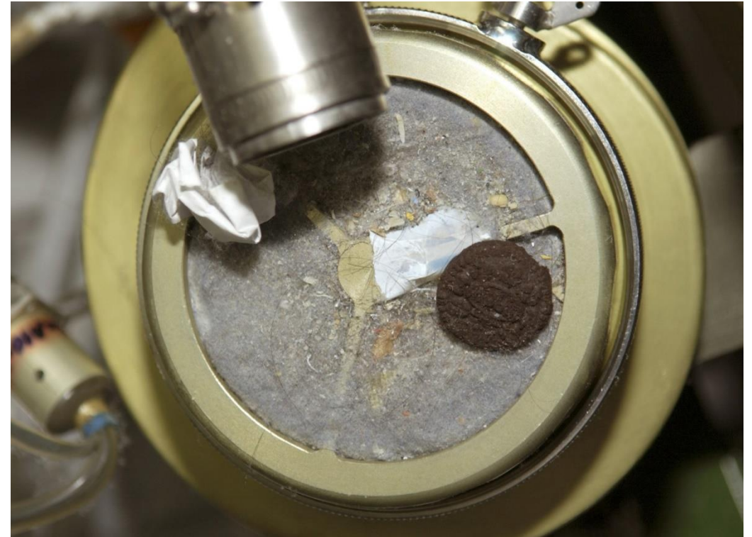
Dirty avionics intake fan
